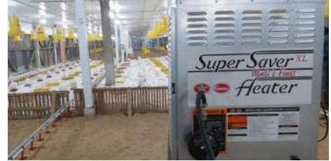
Penggunaan space heater pada kandang broiler closed house
